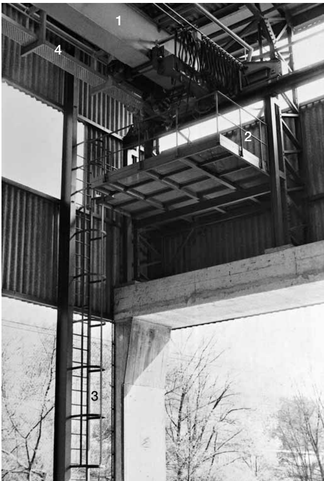
Bild 16: Einträgerkran mit Unterflanschlaufkatze. Zur Wartung der Unterflanschlaufkatze und des Hubwerks ist am Gebäude ein Podest angebaut. Von diesem aus können alle zu wartenden Teile erreicht werden. Der Abstand zwischen untersten festen Teilen an der Unterflanschlaufkatze und dem 1,1 m* hohen Geländer beträgt 0,5 m. Der Aufstieg auf das Podest erfolgt über eine Leiter mit Rückenschutz.
