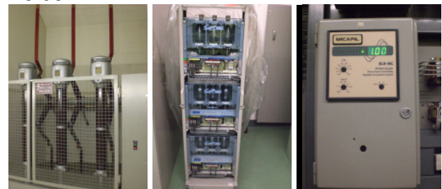
HS-Wandler MS-Schützen Blindstromregler
