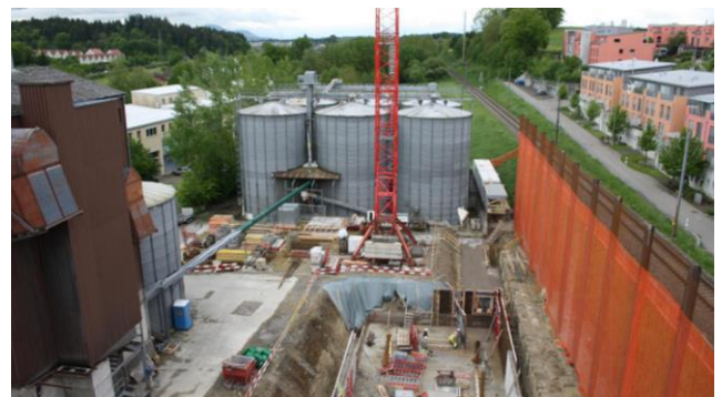
Bild (v.l.n.r): Silo 1 / 104 & Rundsiloanlage
