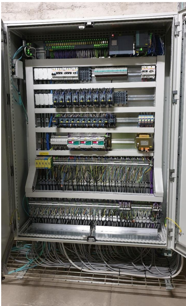
Schaltschrank mit neuesten Komponenten
